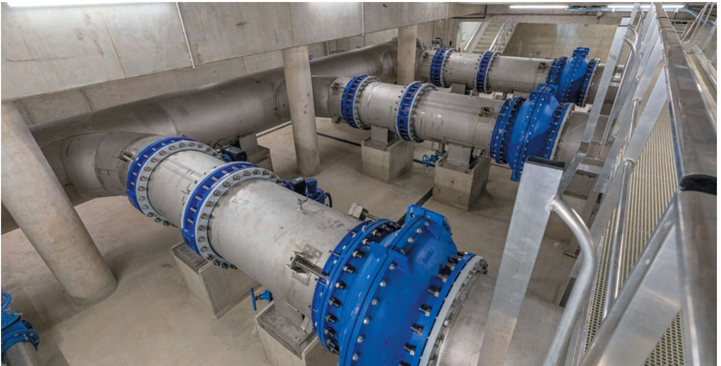
Trois nouvelles pompes ont été installées pour relever les eaux de la darse © Didier Gauducheau
